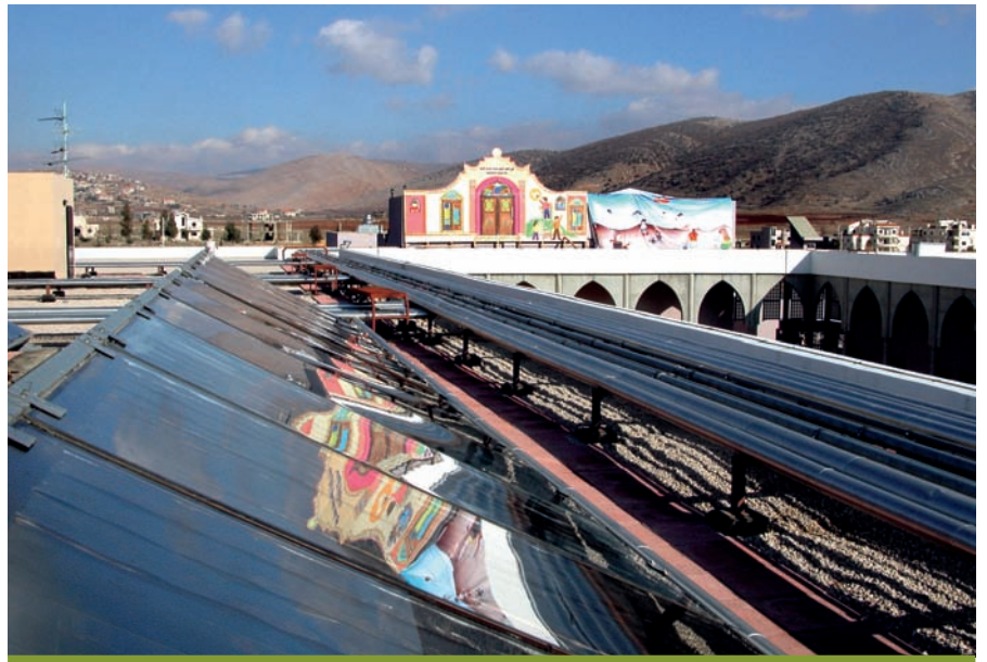
Chauffe-eau solaire sur la toiture de l'orphelinat de Khirbet Rouha.
